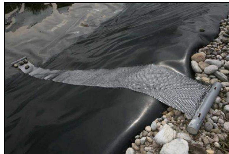
Figure 12 : Echappatoire installé sur un bassin
